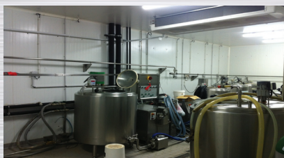
Réseau RIA - Usine de glace
